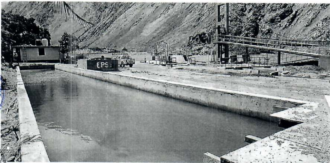
Unidad de pre-sedimentación en Bocatoma "El Canuto"
